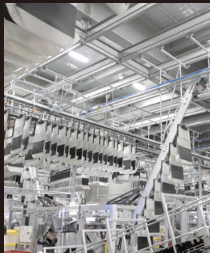
②保管エリア 商品が投入されたポケットは保管エリアに運ばれます。ポケットソーターは上方向へ移動するレイアウトにも対応可能で、デッドスペースになりがちな上部空間を有効活用できます。保管エリアでは、同一オーダーの全ての商品が揃うまでポケットを一時保管します。
