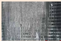
熱交換器の腐食
